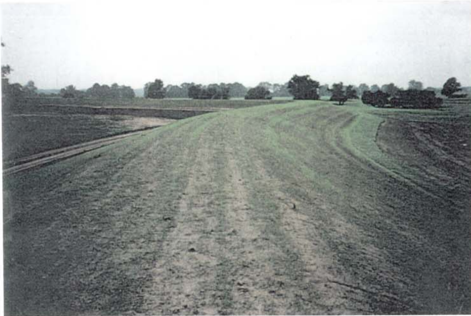
Sanovaná, 5 m vysoká hráz na Labi u obce Beuster v Sasku-Anhaltsku s travnatým pokryvem na návodní patě hráže - služební komunikace na vzdušné straně hráže (M. Müller)
